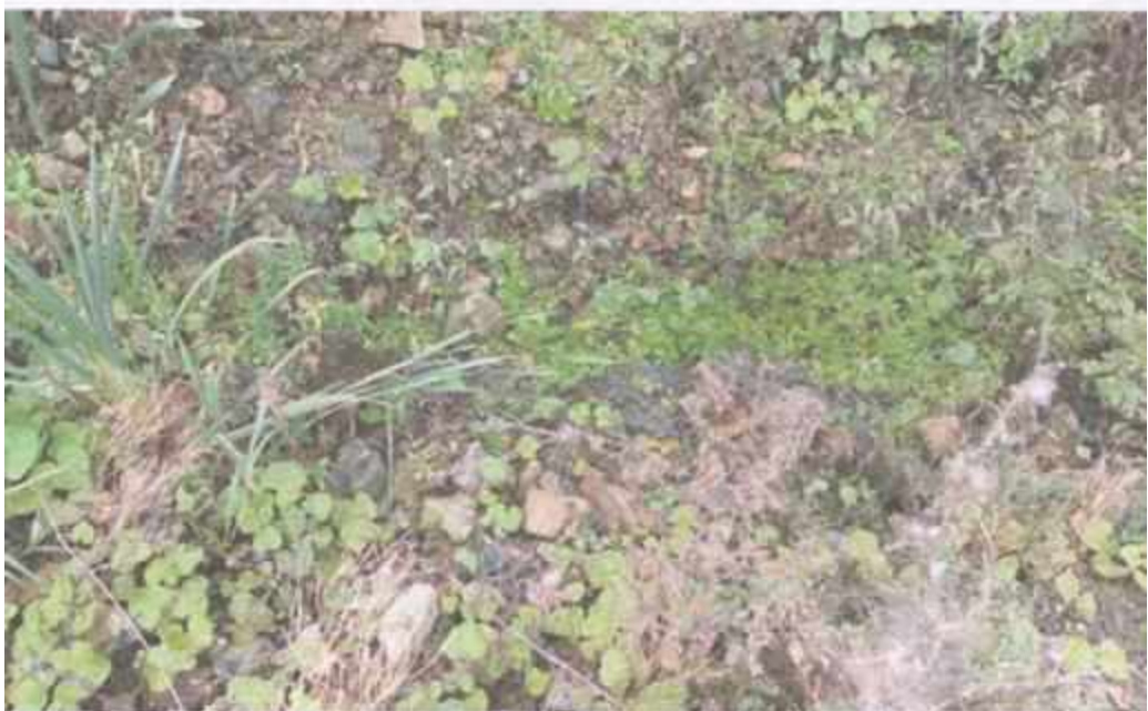
Мал. 3.6 - Фото водопрояву № 2в
