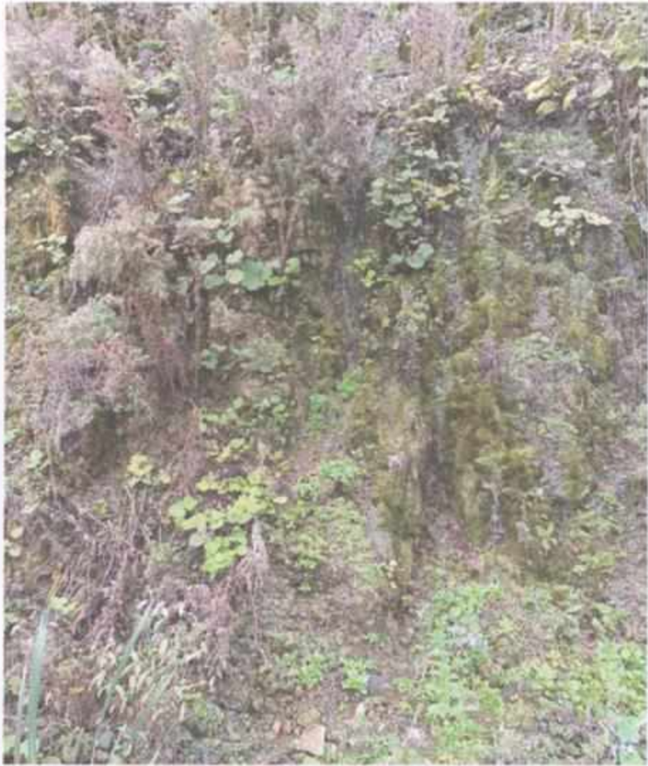
Рисунок 3.5 – Фото водопрояву №2в
